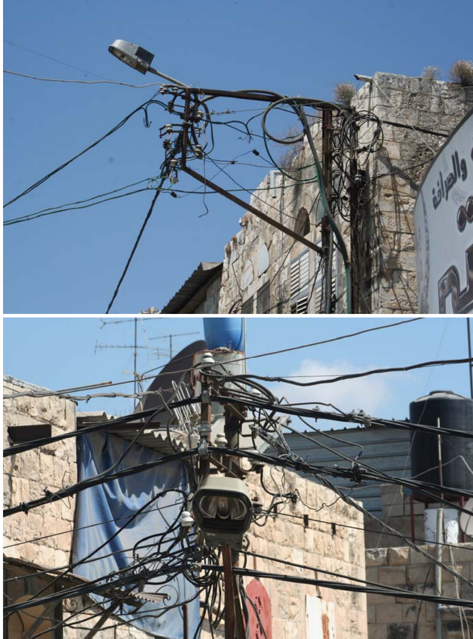
صورة (3): تشابك أسلاك أعمدة الإنارة في الشوارع
